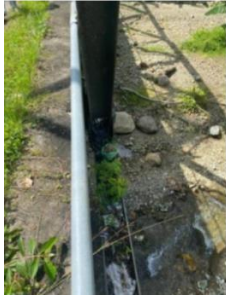
Gambar 6. Trotoar Jembatan WaiBoyan Sumber: Dokumentasi
