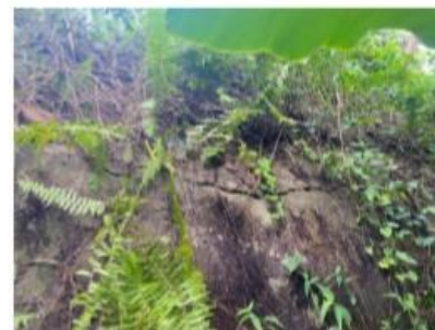
Gambar 5. Retak pada DPT Sumber: Dokumentasi
