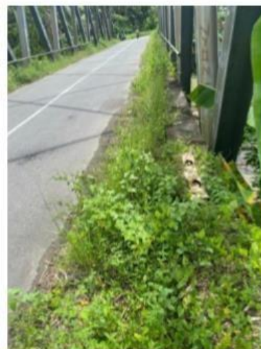
Gambar 2. Drainase yang tersumbat Jembatan Wai Boyan
