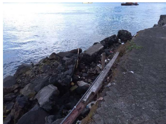
Gambar 3.6. Tanggul yang rusak akibat abrasi
