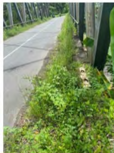
Gambar 2. Drainase yang tersumbat Jembatan Wai Boyan
