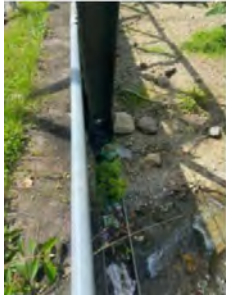
Gambar 6. Trotoar Jembatan WaiBoyan Sumber: Dokumentasi
