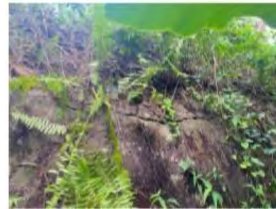
Gambar 5. Retak pada DPT Sumber: Dokumentasi
