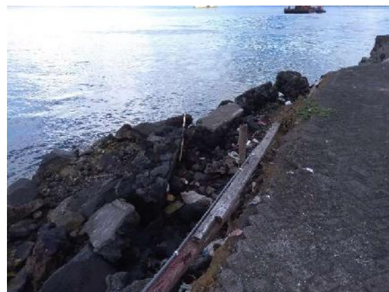
Gambar 3.6. Tanggul yang rusak akibat abrasi
