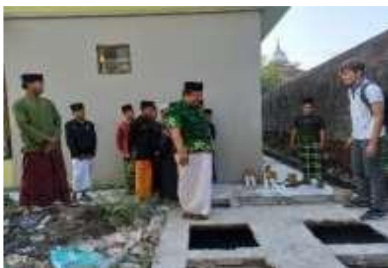
Gambar 5. Proses pembangunan sistem sanitasi dan instalasi pengolahan limbah cair domestik pondok pesantren Kalimasada Jombang
