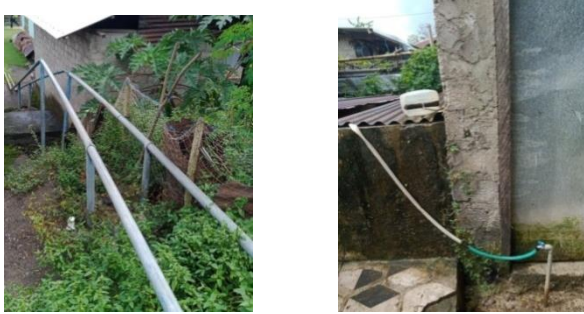
Gambar 4 Jaringan Pipa di Desa Lonthoir
