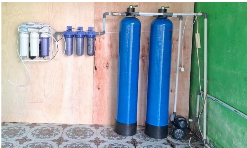
Gambar 4. Instalasi pengolahan air bersih dengan teknologi membran reverse osmosis
