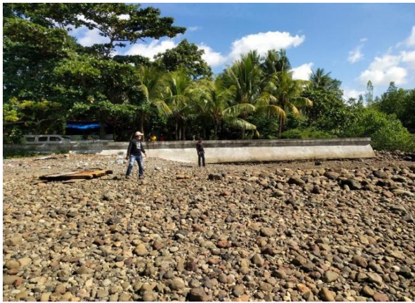
Gambar 7. Struktur pertahanan pantai yang dibangun tidak utuh di Tawiri. Foto bulan Maret 2022.
